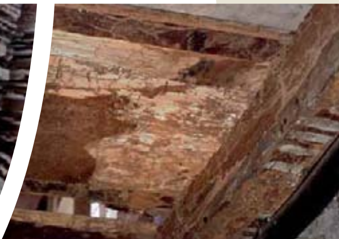
Attaques sur un solivage de plancher
